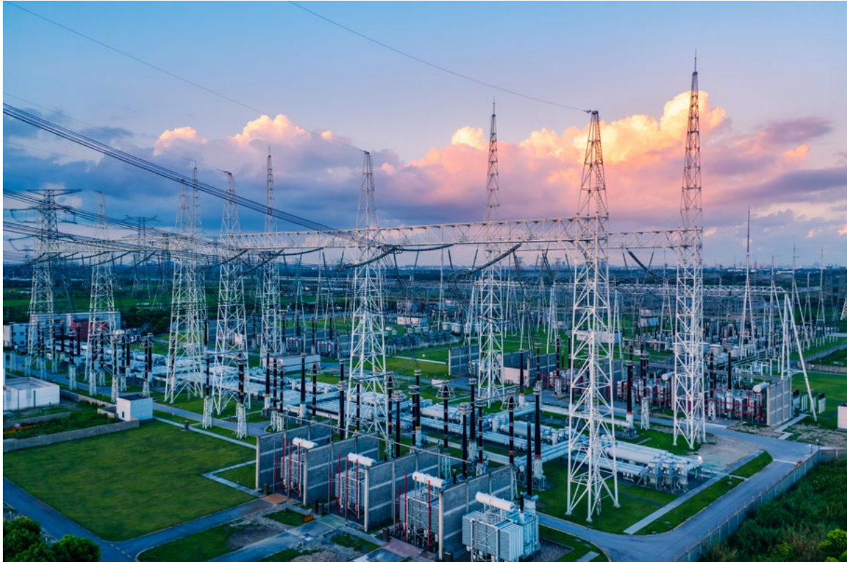
Umspannwerke - stadttechnische Infrastruktur mit erheblichem Flächenbedarf. Foto: Adobe Stock/ABCDstock.
