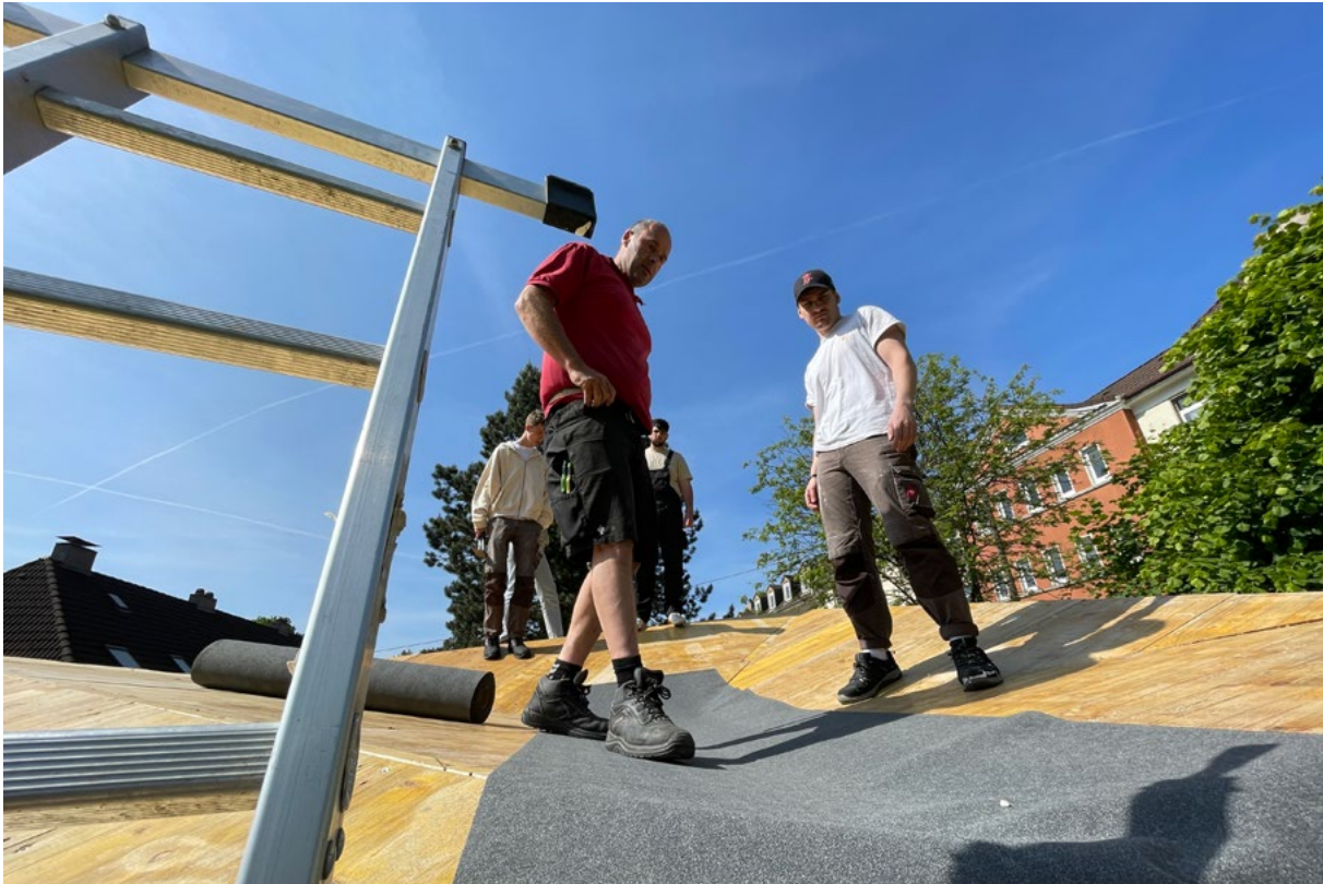
Abbildung 6: In Kooperation mit dem lokalen Dachdeckerhandwerk lernten Studierende Bitumenbahnen zu verlegen und Wände zu verschiefern. Foto: R. Winterhager/Urbane Nachbarschaft Honsberg.
